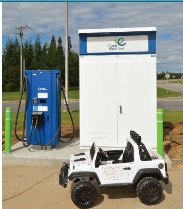
Sur la photo, la nouvelle borne de Circuit électrique récemment érigée à Fermont.
