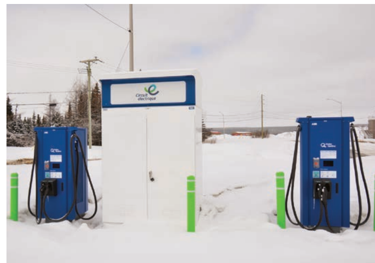
Sur la photo, les deux nouvelles bornes de recharge de Circuit électrique qui attendent patiemment d'être alimentées en énergie afin de pouvoir ravitailler des véhicules électriques ont croupi sous la neige tout l'hiver.
